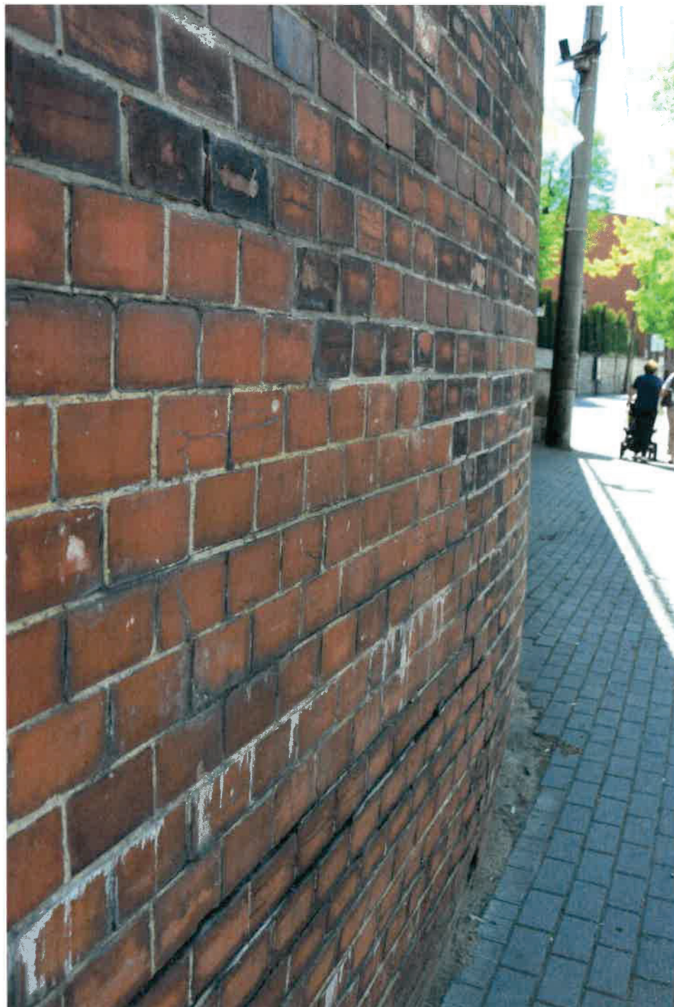
Fragment muru pomiędzy schodami zewnętrznymi, widoczne niebezpieczne odkształcenie w dolej partii ściany, pionowe pęknięcie, wypchane na skutek wybrzuszenia fugi, zawilgocenie i zasolenie muru.
